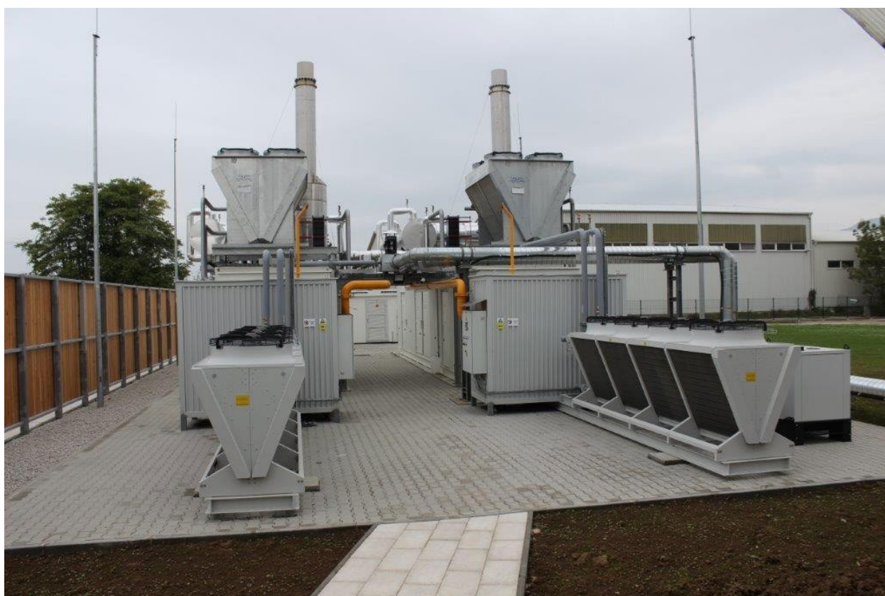
Obr. 13 Pohľad na kogeneračné jednotky KGJ1 a KGJ2 v areáli CTZ Nitra-Chrenová
