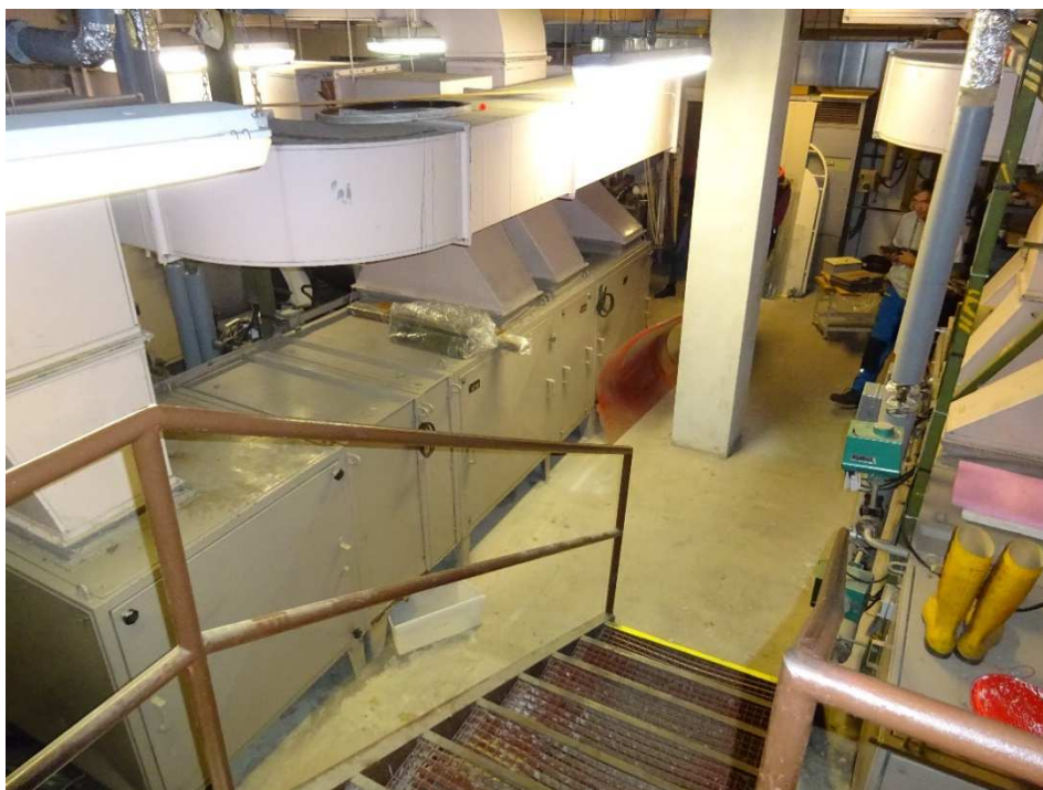
Obrázok 16 – Strojovňa vzduchotechniky na prízemí
