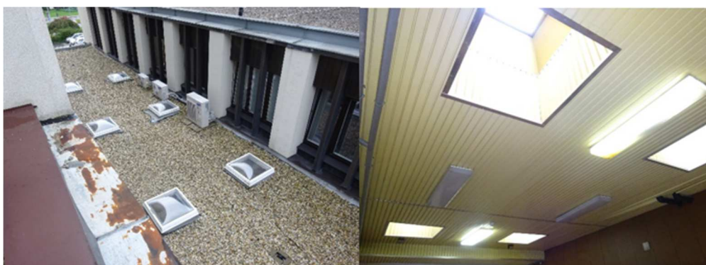
Obrázok 28 – Stropné svetlíky inštalované na streche nad chodbou na prízemí
