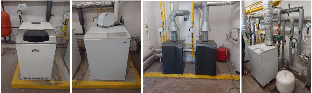
Obr. 2: Kotly osadené v kotelniach
