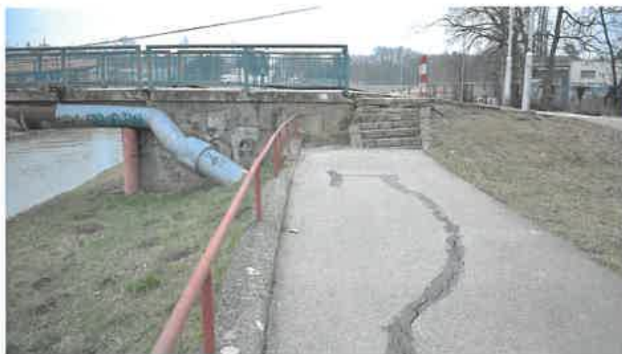
Obrázok 7: Trhlina v chodníku ako dôsledok zosúvania svahu
