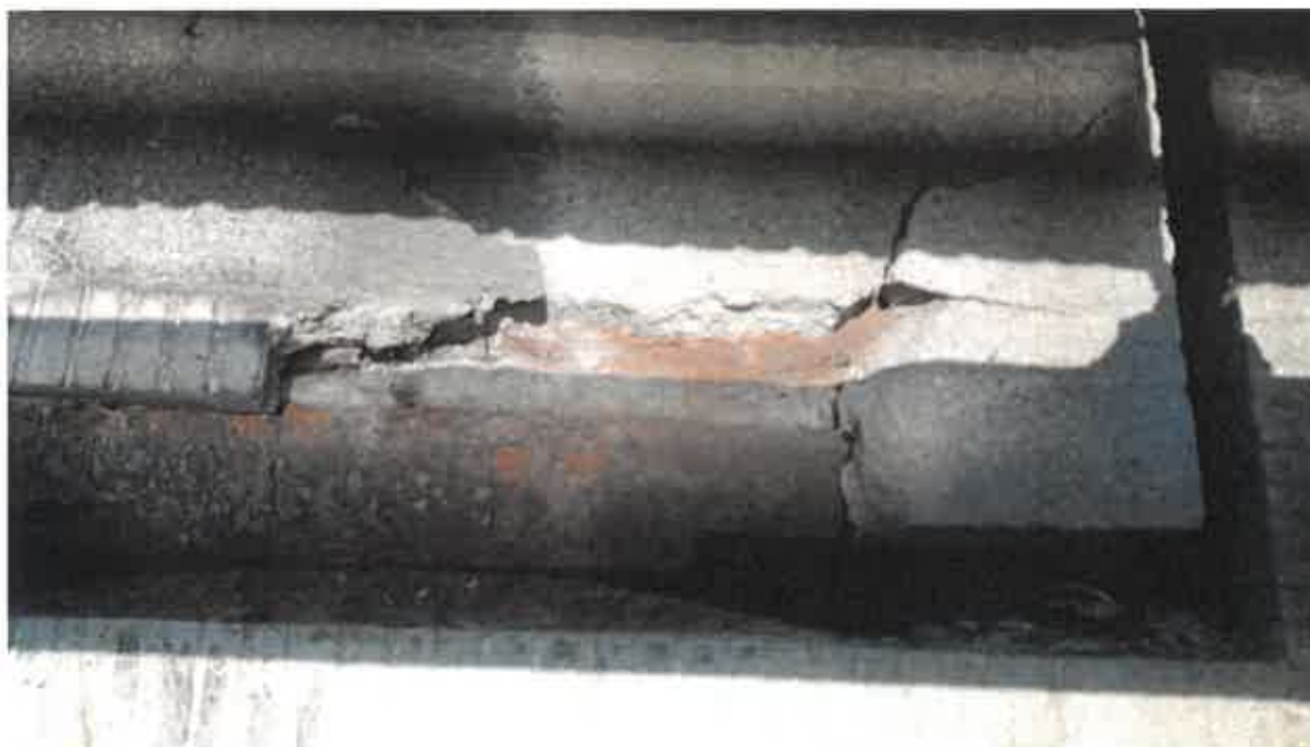
Obrázok 59: Kíb v nosnej konštrukcii – v blízkosti piliera č. 1 (I)
