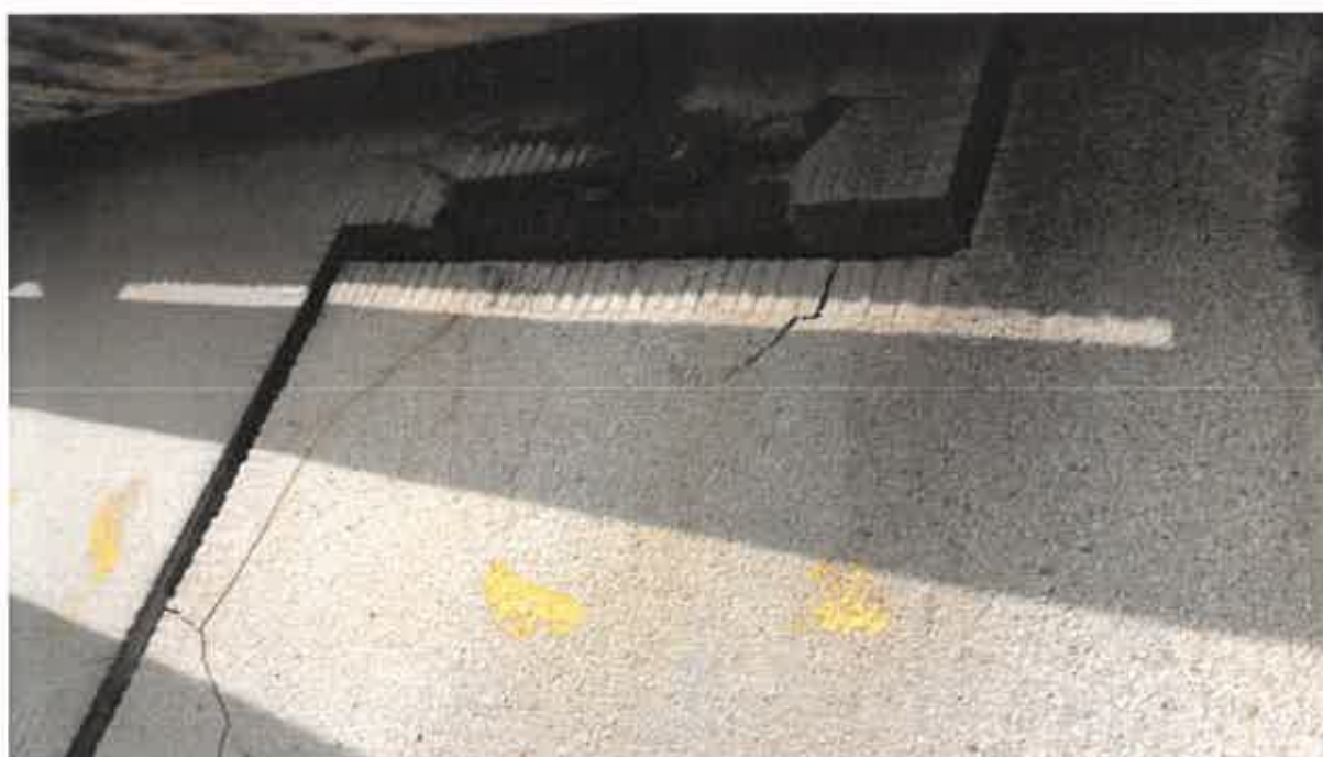
Obrázok 60: Kíb v nosnej konštrukcii – v blízkosti piliera č. 1 (II)
