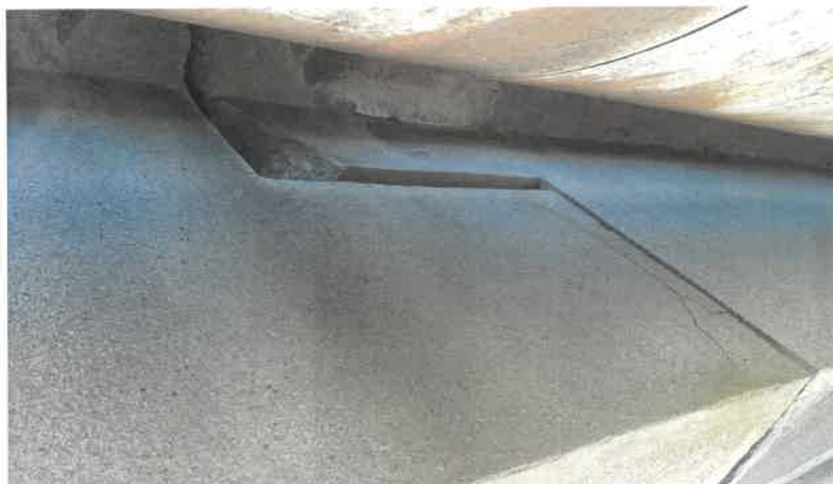
Obrázok 62: Kíb v nosnej konštrukcii – v blízkosti piliera č. 1 (IV)
