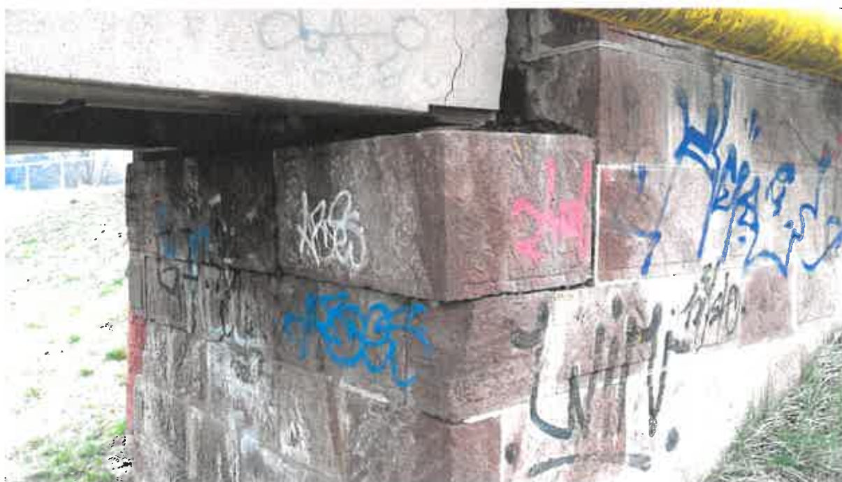
Obrázok 26: Ľavobrežná opora – poruchy muriva a uvoľnený úložný prah
