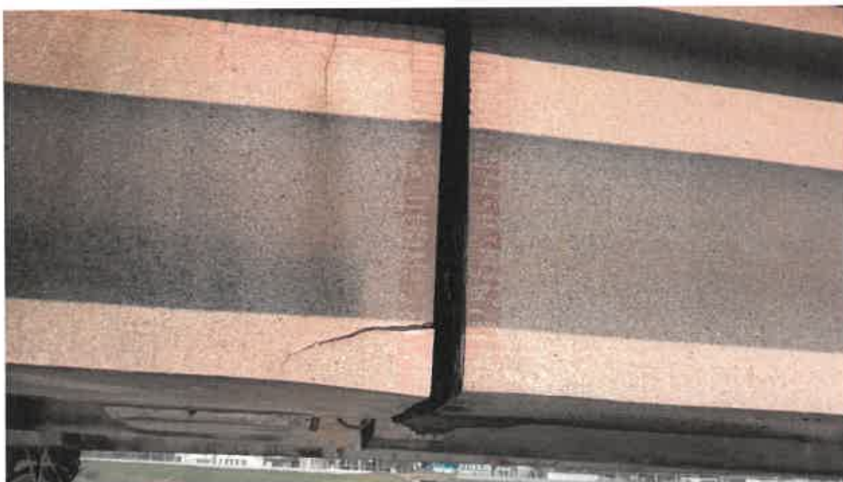
Obrázok 66: Kĺb v nosnej konštrukcii – v blízkosti piliera č. 2 (IV)
