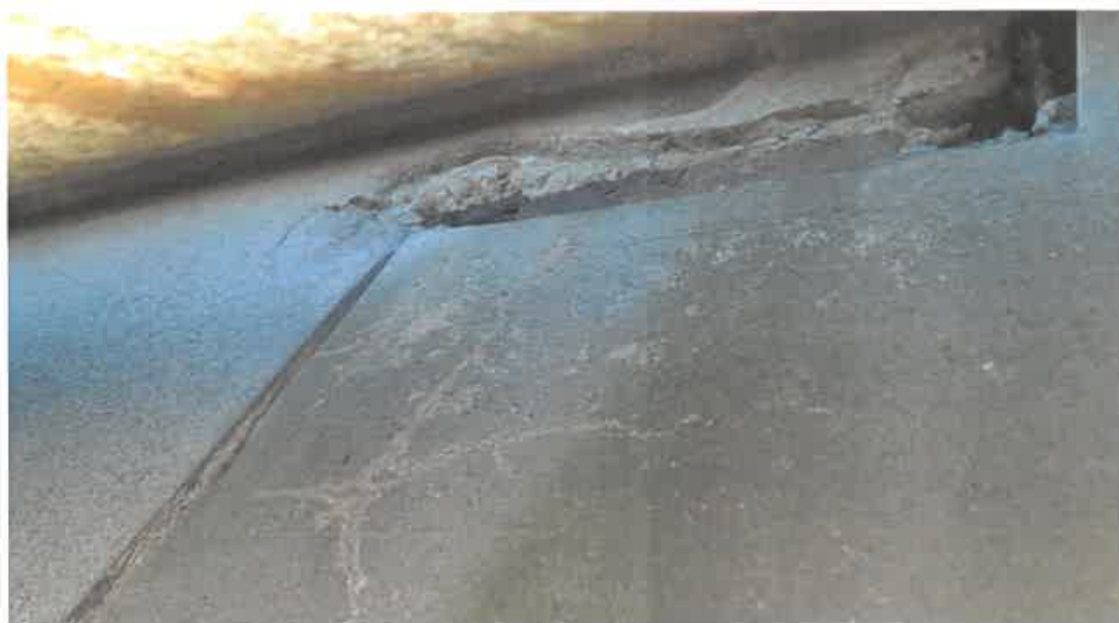
Obrázok 64: Kĺb v nosnej konštrukcii – v blízkosti piliera č. 2 (II)
