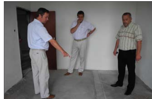
Primátor Jozef Dvonč si priebeh rekonštrukcie hotelových izieb na byty pozrel v sprievode riaditeľa Službytu Pavla Bielika.
