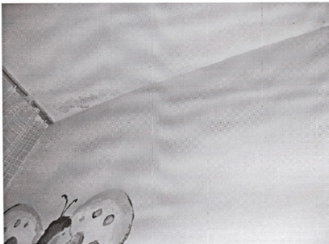
Poškodenia pri strope
