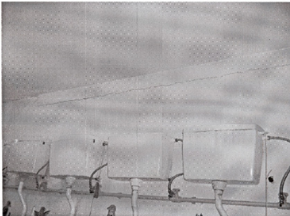
Vodorovná trhlina na obvodovom múre z vnútornej strany - spôsobená priamo nerovnomerným sadnutím základového pásu
